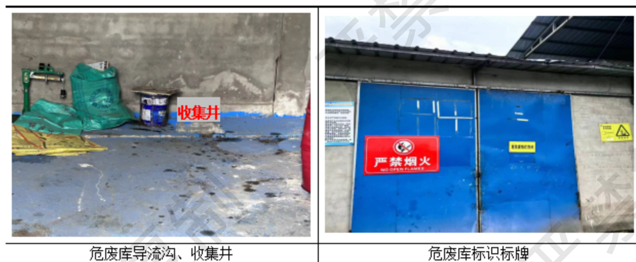
图 2.3-4 现有项目废水环保设施
