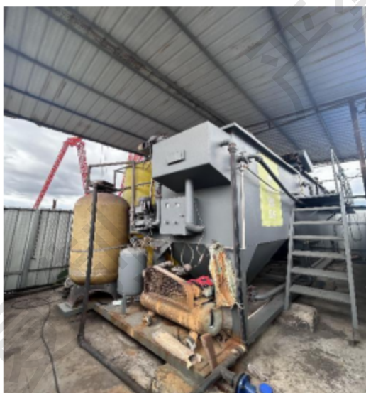
污水处理设施
